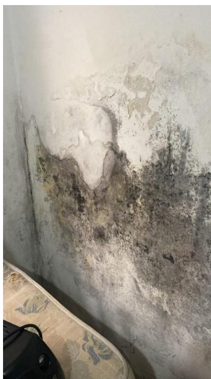
Foto 24 – Parede do hall de acesso aos quartos e banheiros com infiltração
