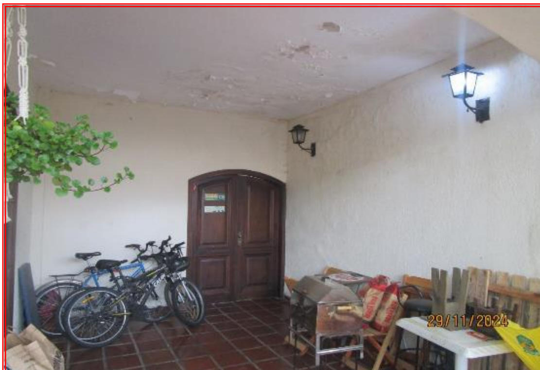
Foto nº 08: Outra vista geral da garagem coberta, onde se observa vestígios de infiltração da laje de cobertura e parede de divisa.
